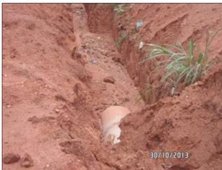
Figura 78 - Obstrução do canal de microdrenagem inacabado
