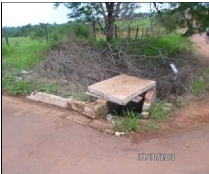
Figura 74 - Boca de lobo em mau estado de conservação e acúmulo de lixo na vala de infiltração
