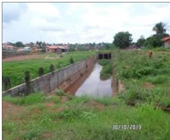
Figura 67 - Dispositivos de macrodrenagem Fonte: E.C.P. Soluções (2014).
