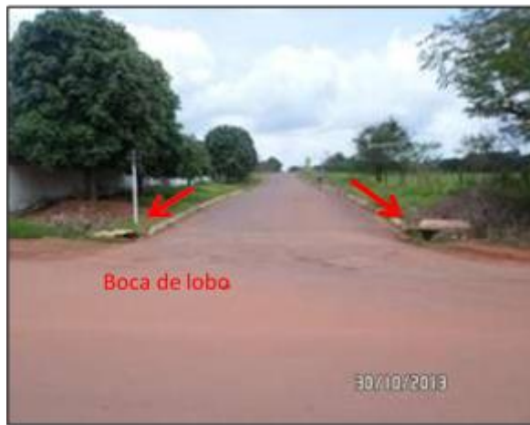
Figura 73 - Via pavimentada com presença de dispositivo de microdrenagem Fonte: E.C.P. Soluções (2014).
